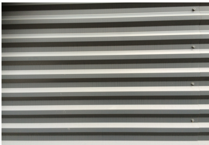
0-Situatie: Damwandbeplating sterk verontreinigd door met name atmosferische verontreiniging.
