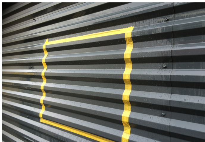
Damwandbeplating geconserveerd met PreCare EasyProtect ® , duidelijk afparelend effect zichtbaar.
